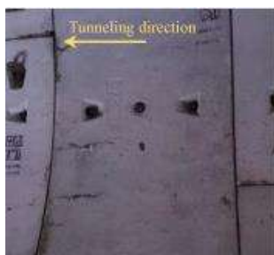
ترک طولی وجوه ناشی از بار متمرکز جک‌ها
