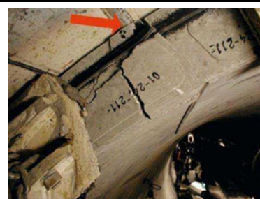
شکستگی سگمنت ناشی از تمرکز تنش بار نامتقارن جک
