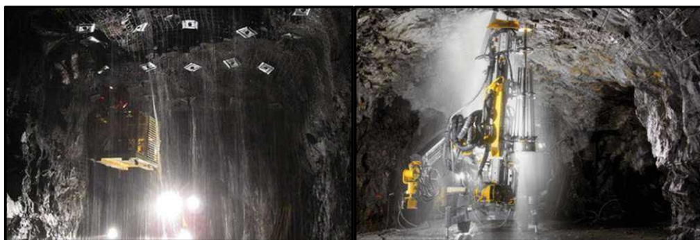
شکل ۳-۱۹- هجوم و نشت آب هنگام حفاری برای نصب مهار و پیچ سنگ
