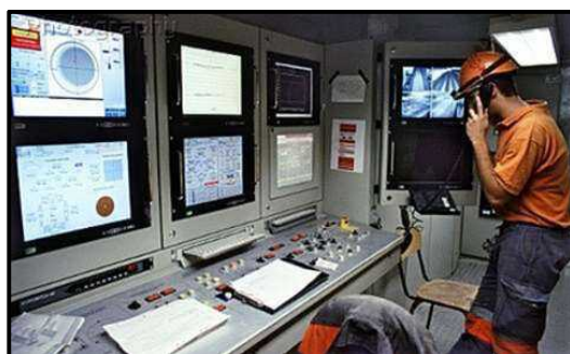
شکل ۵-۱۲- اتاق کنترل ماشین حفاری مکانیزه مجهز به سامانه پایش، پردازش، ذخیره و انتقال اطلاعات و کنترل از راه دور ماشین
