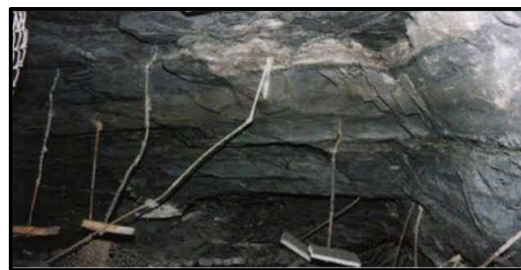
شکل ۳-۲۱- گسیختگی کلی سیستم پیچ سنگ در زون پلاستیک
