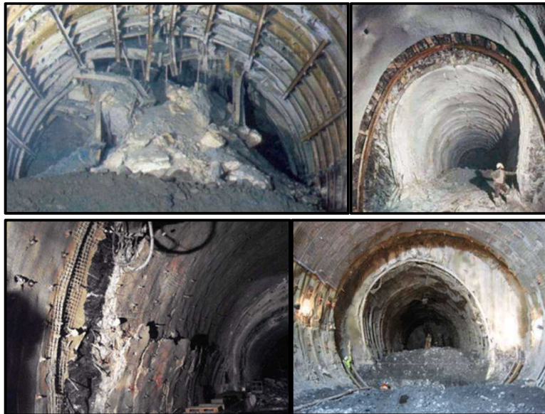
شکل ۳-۱۲- ریزش موضعی تونل، تغییر شکل مفرط و آسیب دیدگی سامانه نگهداری و نیاز به تقویت و ترمیم آن
