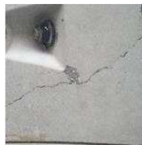
ترک خوردگی ناشی از سفت کردن بیش از حد بولت
